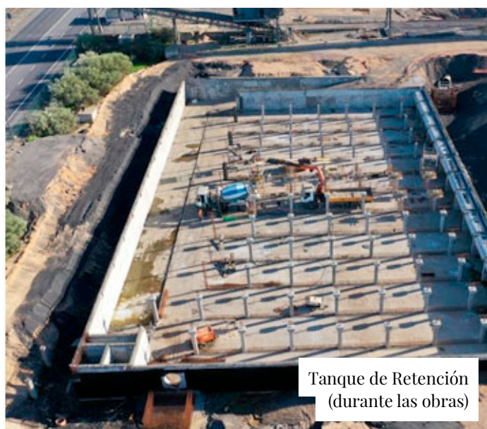
Recogida de aguas en el Muelle Ingeniero Juan Gonzalo (durante las obras)
