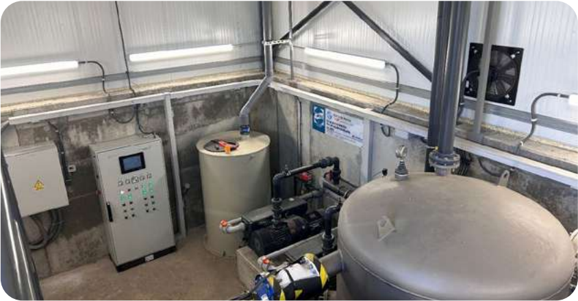
Estación de vacío (finalización de las obras).
